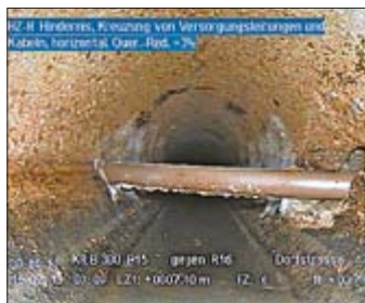
Kurios, was die Kamera unter der Erde erblickte: Eine Gasleitung geht quer durch den Niederschlagswasserkanal.
