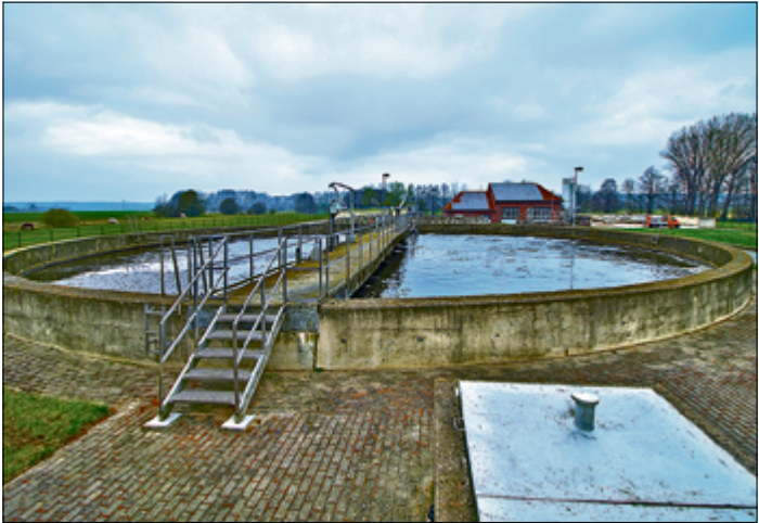
Die Kläranlage Dobbartin ist eine der Anlagen, auf denen Eisenschlamm aus den Wasserwerken des WAZV zur Eliminierung von Phosphor eingesetzt wird.
