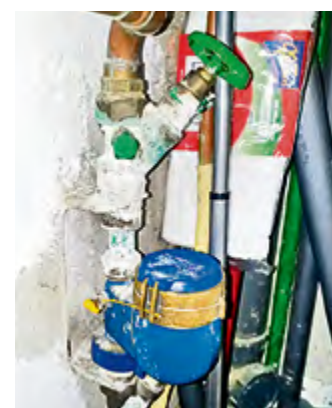
Ausblühungen an der Wasserzähleranlage können im Extremfall so aussehen.
