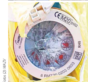
Diese Bilder von geplatzten Wasserzählern haben unsere Mitarbeiter vor Ort gemacht.
