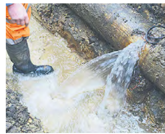
Rohrbrüche passieren weitaus seltener, als man denkt. Foto: SPREE-PR
